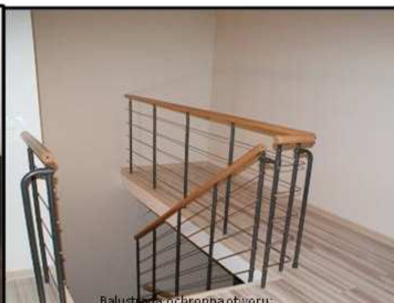
Balustrada ochronna otworu
